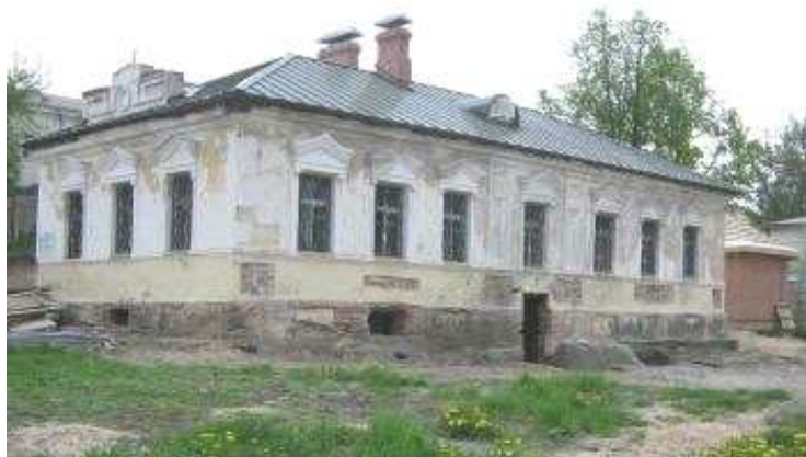
Рисунок 14. – Внешний вид здания во время реставрационных работ после замены крыши и кровельного покрытия (2011 г.)
