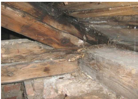
Рисунок 10. – Загнивание и плесень на стропильной ноге в опорном узле по оси «Б»
