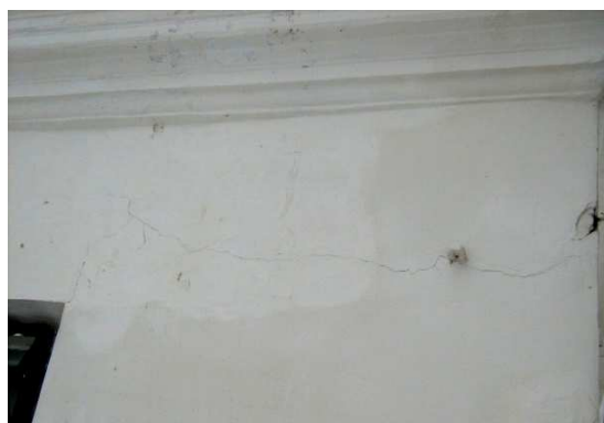
Рисунок 5. – Трещина по штукатурному слою стены по оси «Б» на пересечении с осью «1»
