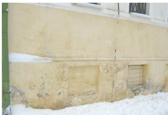
Рисунок 4. – Разрушение штукатурного слоя цокольной части стены по оси «А»
