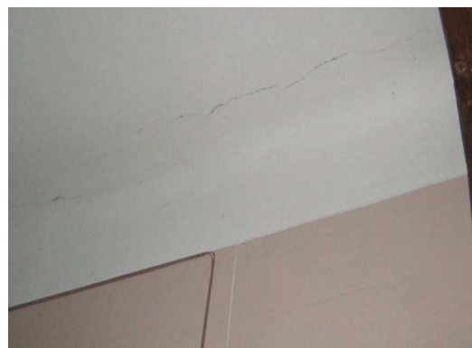
Рисунок 9. – Трещины в местах примыкания потолка к наружной стене по оси «А»
