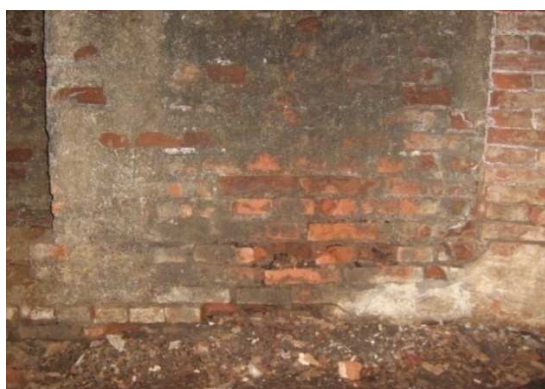
Рисунок 6. – Разрушение кладки наружной стены подвала по оси «4»
