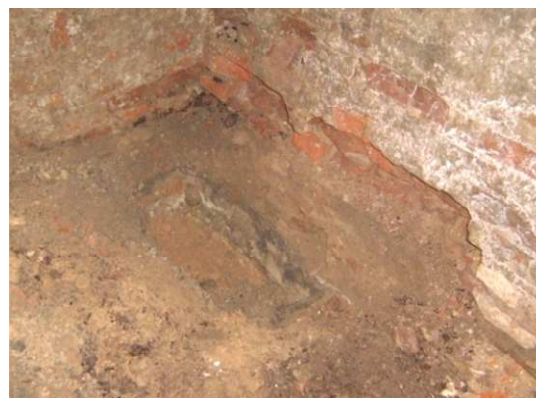
Рисунок 11. – Разрушение внутренней версты кладки фундамента на пересечении осей «Б» и «4»
