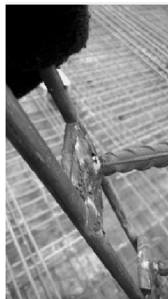
1 – вид изделия согласно проекту (вверху); 2 – дефекты сварных соединений (внизу)
