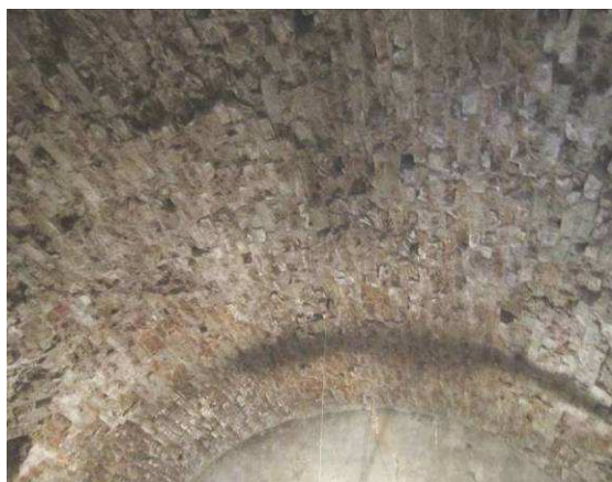
Рисунок 9. – Разрушение кладки свода 1-го этажа
