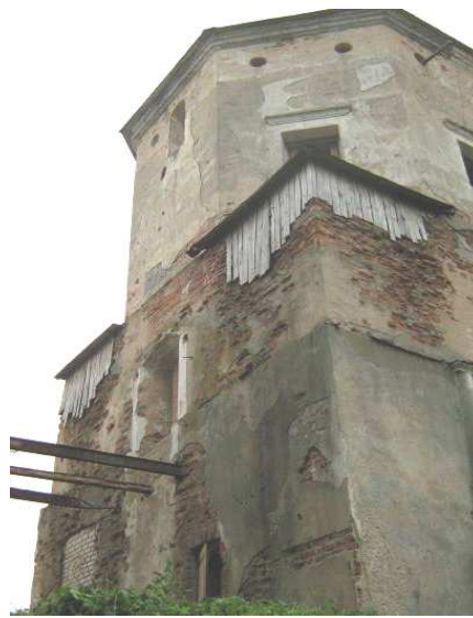
Рисунок 3. – Разрушение кирпичной кладки башни (2008 г.)
