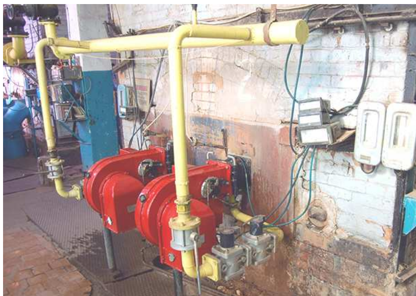
Рисунок 1. – Котел ДКВр-6,5-13 ГМ, оборудованный для сжигания природного газа
