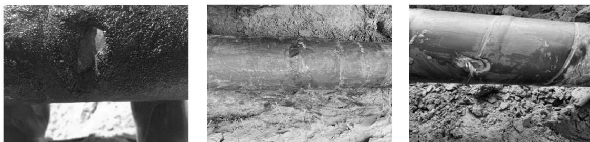
Рисунок 1. – Типичные повреждения изоляционного покрытия газопроводов
