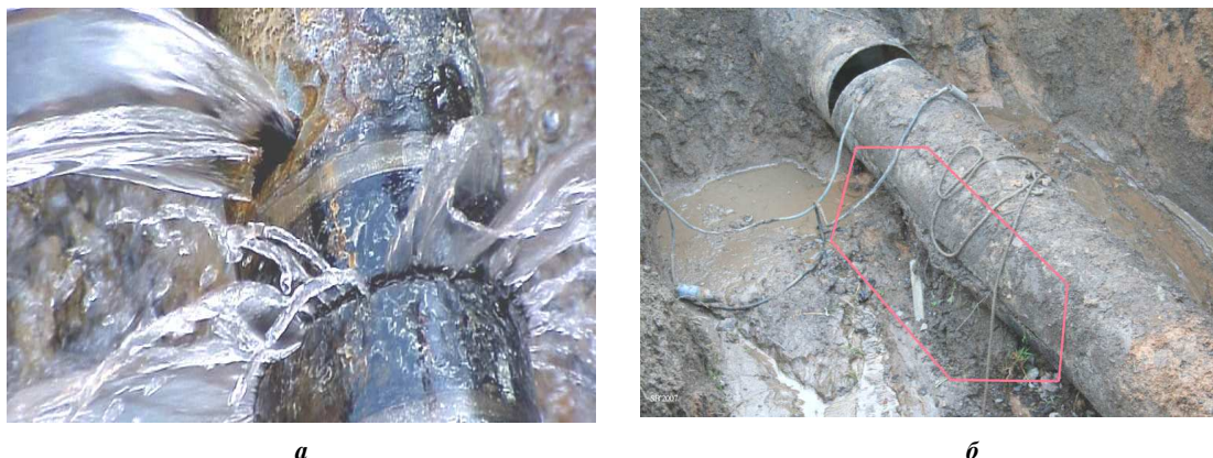
a – свищи (дыры), трещины; б – переломы, разрывы
