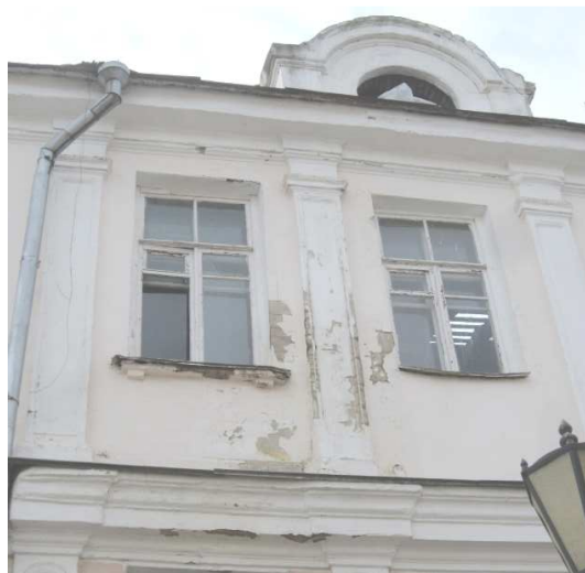
Рисунок 5. – Местные участки, имеющие повреждения отделочного штукатурного слоя наружной стены по оси А
