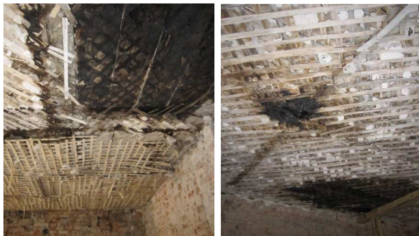
Рисунок 10. – Техническое состояние междуэтажных перекрытий
