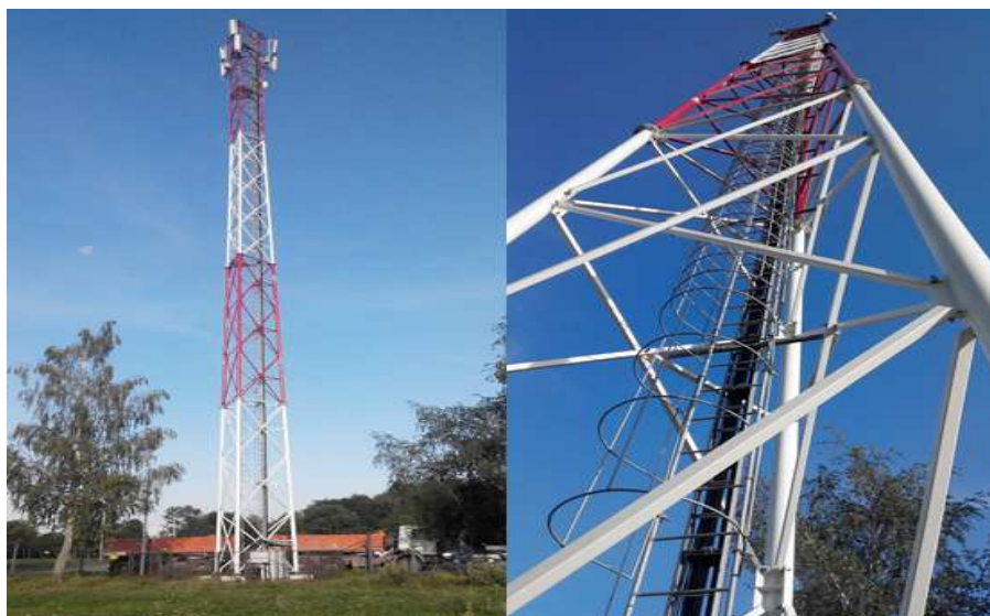
Рис. 1. Металлическая башня связи треугольного сечения
