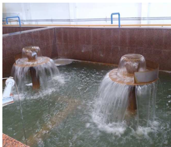
Рисунок 12 – Излив воды в корпусе фильтра
