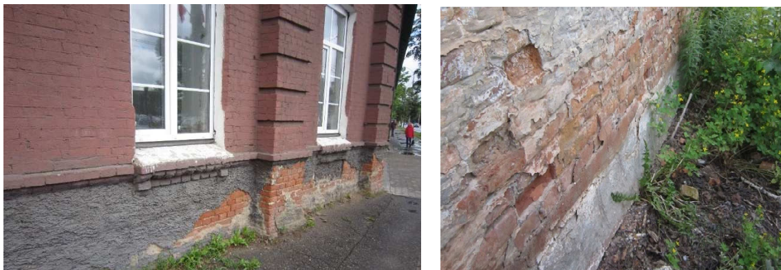
Рисунок 9. – Разрушение штукатурного отделочного слоя цоколя основного здания и одноэтажной пристройки
