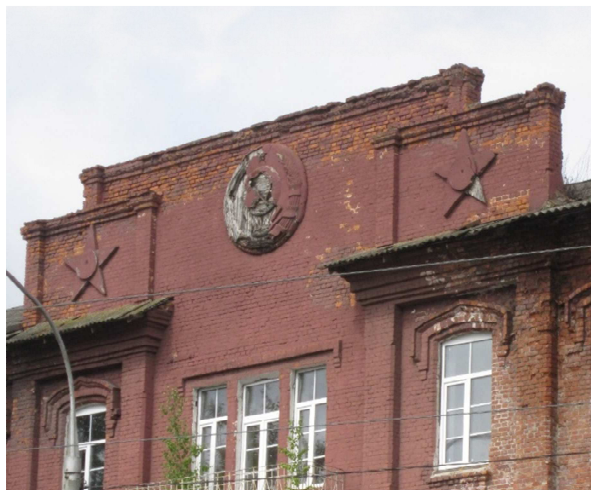
Рисунок 10. – Повреждение кирпичной кладки фронтона над главным входом по оси А в осях 7–12
