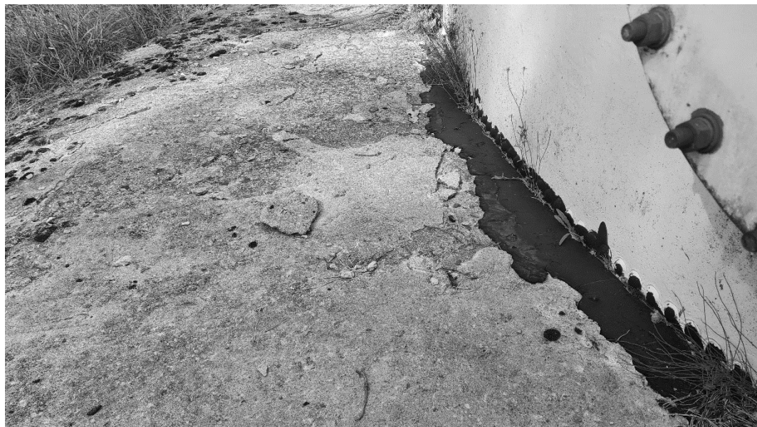
Рисунок 5. – Текущее состояние отмостки РВК-1000
