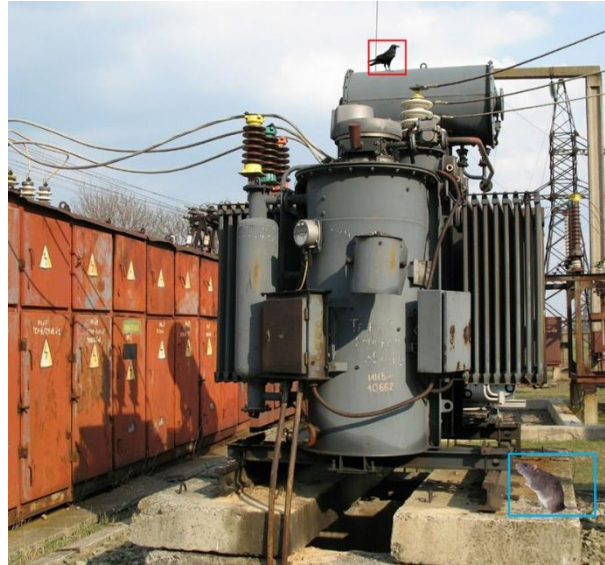
Рисунок 5. – Пример фотофиксации посторонних объектов (птиц и грызунов) в трансформаторной подстанции
