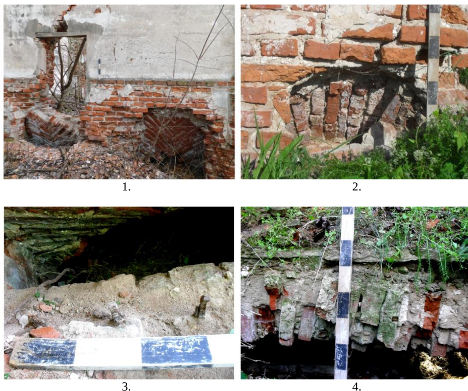
1. – по южной стене; 2. – по восточной стене; 3. – фрагмент окна подвала юной стены: видны выкладка подоконника кирпичом на ребро и остатки кованых прутьев; 4. – фрагмент свода с цементным полом над ним
