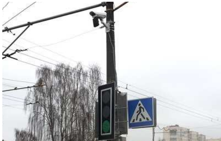
Рисунок 2. – Размещение видеомодуля на опоре уличного освещения
